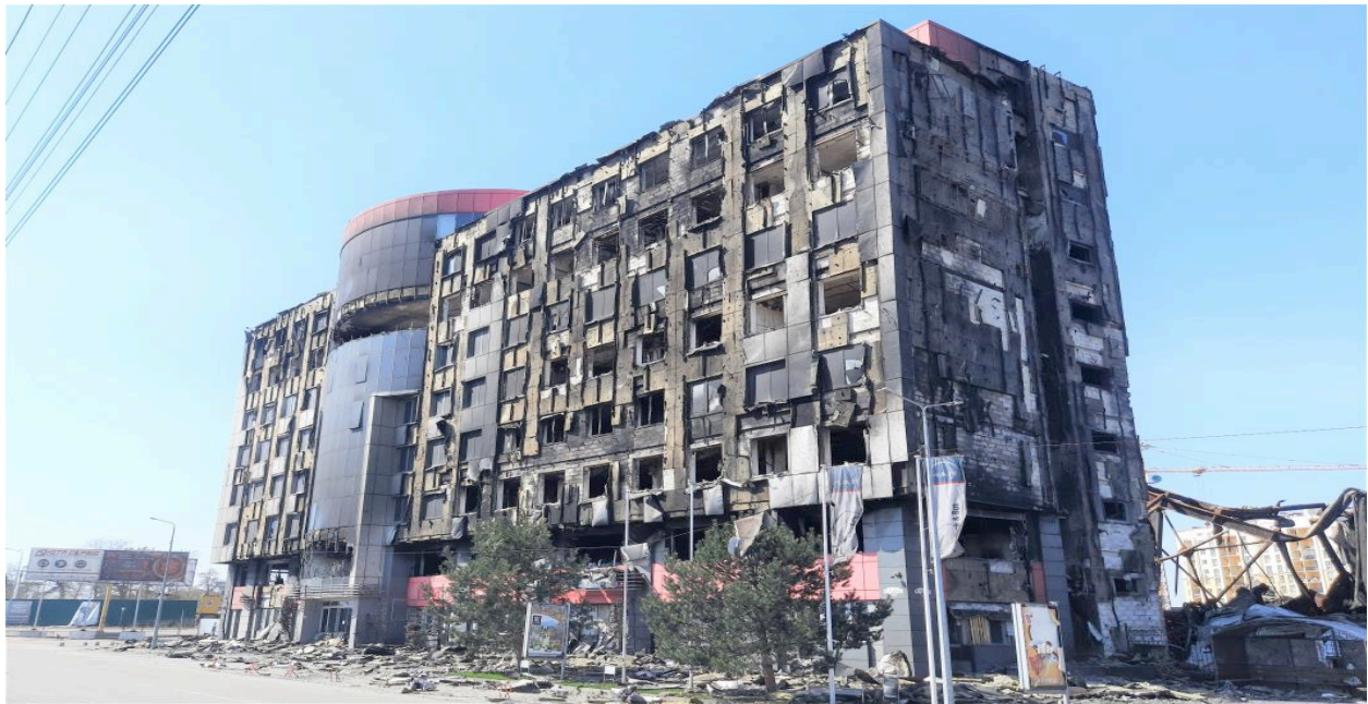
Рис. 1 Загальний вигляд пошкодженої офісної будівлі виробничої бази.
