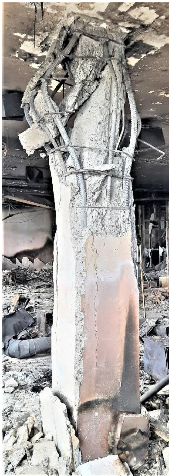
Рис. 5. Руйнування колони третього поверху
