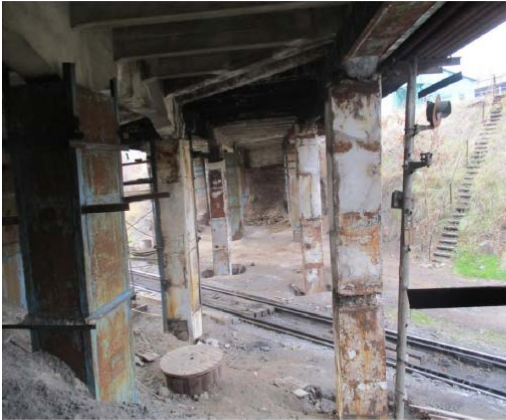
Рис. 3. Загальний стан конструкцій шляхопроводу
