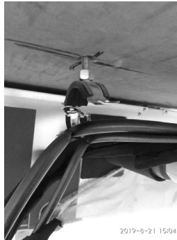
Рис. 1. Руйнування фреоноводу на нерухомій опорі внаслідок температурних деформацій. Результат - витік всього фреону з системи. Фото з відкритих джерел.
