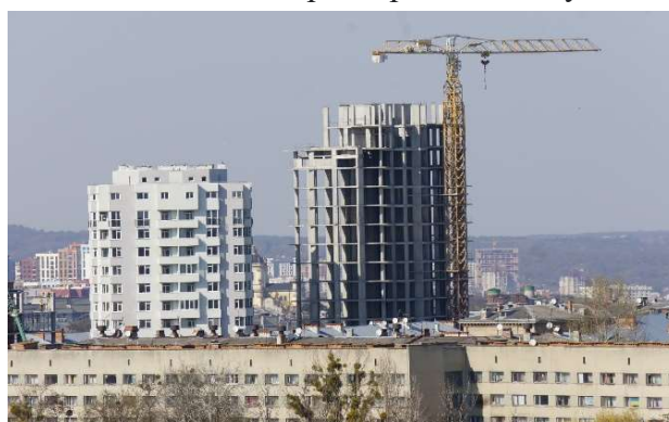
3 — зупинене на п'ять років будівництво по вул. Остроградських (на вимогу громадськості)
